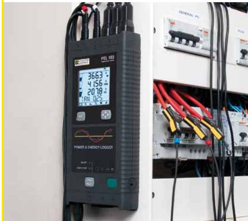
Registrador de potencia y energía PEL 103
